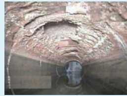
腐食が進行した既設管
