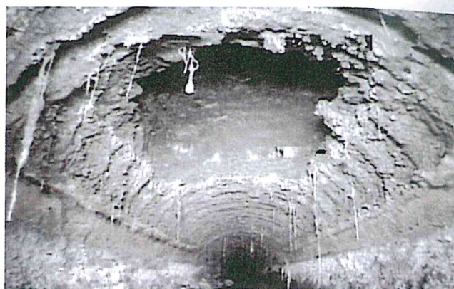
写真-3 陥没した上部空洞
