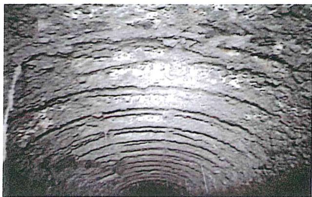
写真-2 上部硫化水素による腐食
